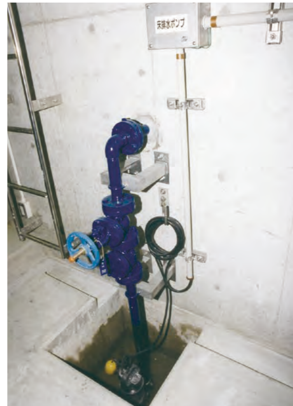
●排水機場の床排水ポンプ用
